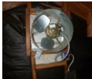
Attic exhaust fan
